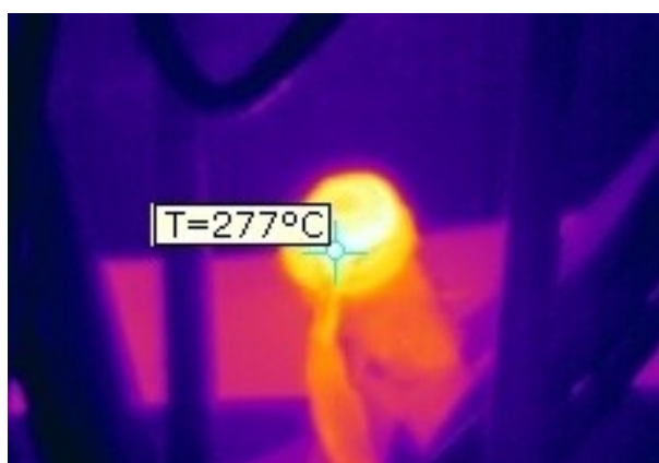
Рисунок 22. Пример обнаружения пожароопасного разогрева болтового контактного соединения
