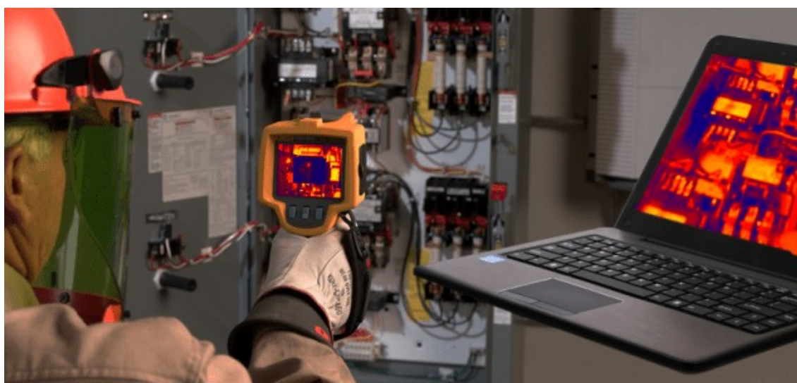
Рисунок 20. Пример проведения тепловизионного контроля электрошкафа
